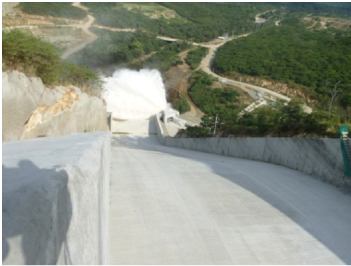
Foto No 7. Canal de descarga y deflector sin flujo 06-12-2010
